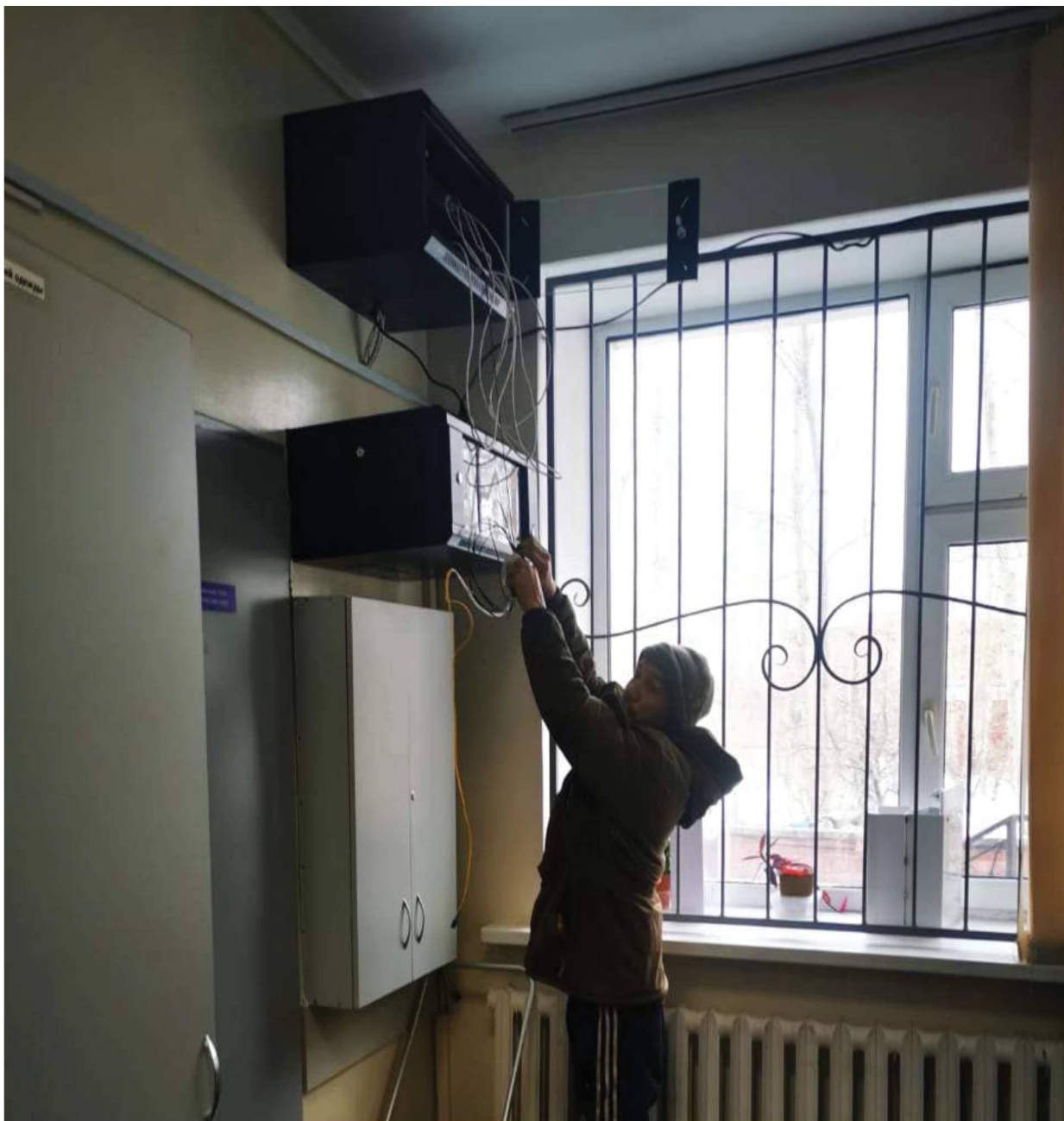
Рисунок 13 – установка телекоммуникационного шкафа
