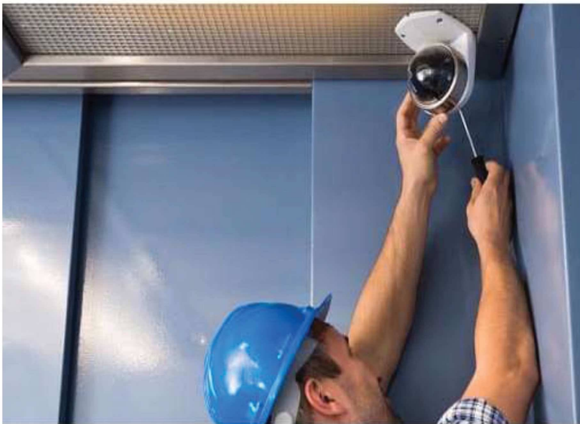
Рисунок 12 – установка камер видеонаблюдения
