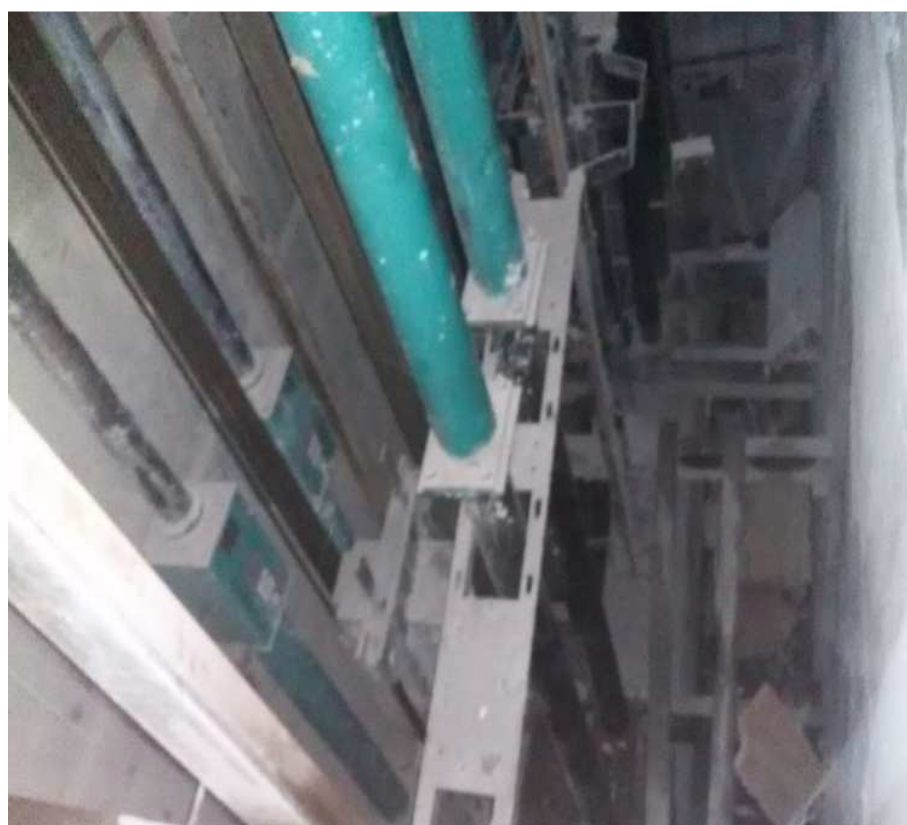
Рисунок 13 – Смонтированные в приемке шахты лифта гидравлические буфера кабины и противовеса
