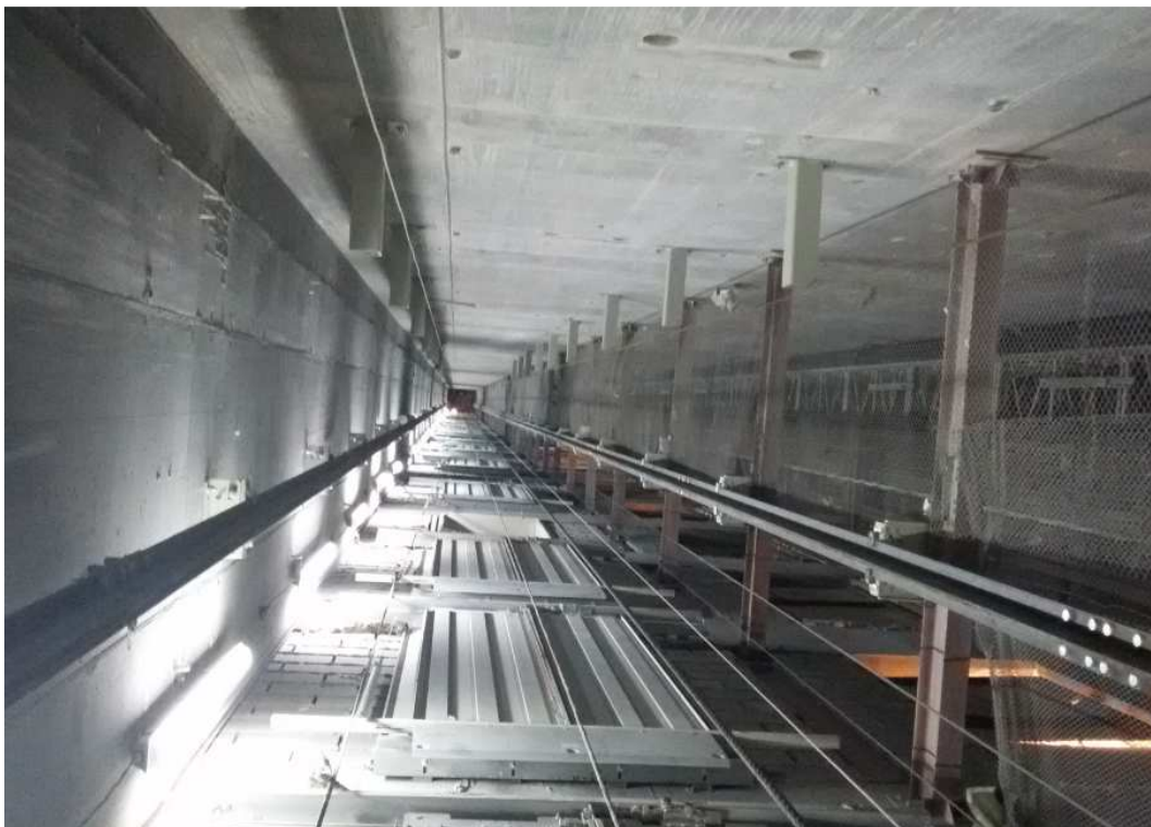
Рисунок 37 – Шахта лифта с направляющими и кронштейнами
