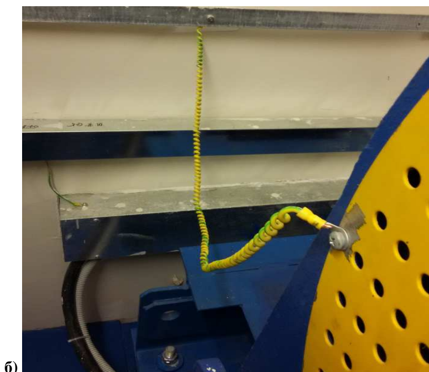
Рисунок 52 – Заземление оборудования лифта
