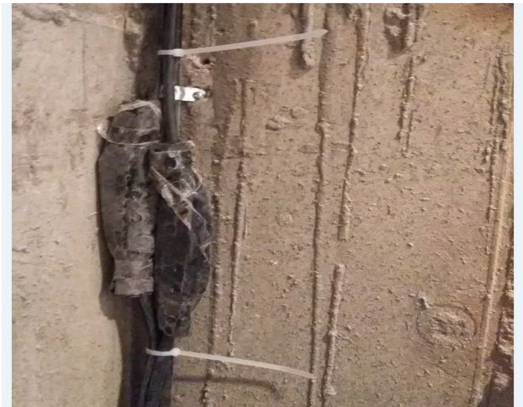
Рисунок 75 – Крепление электропроводки в шахте
