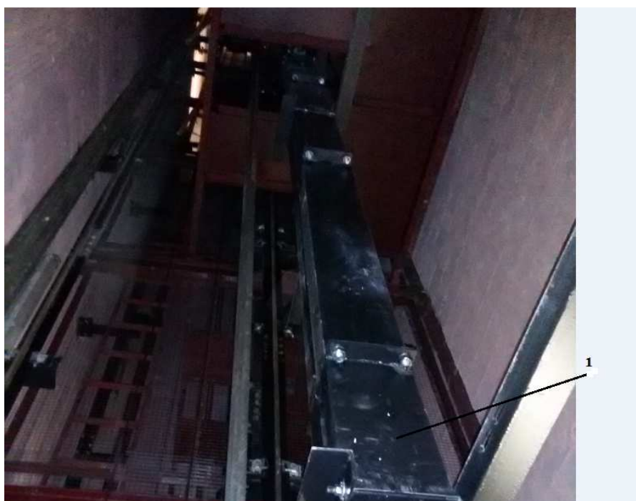
Рисунок 15 – Металлический каркас буферного устройства кабины в приемке лифта 1 - металлический каркас буферного устройства кабины
