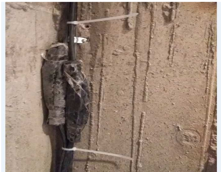
Рисунок 69 – Крепление электропроводки в шахте
