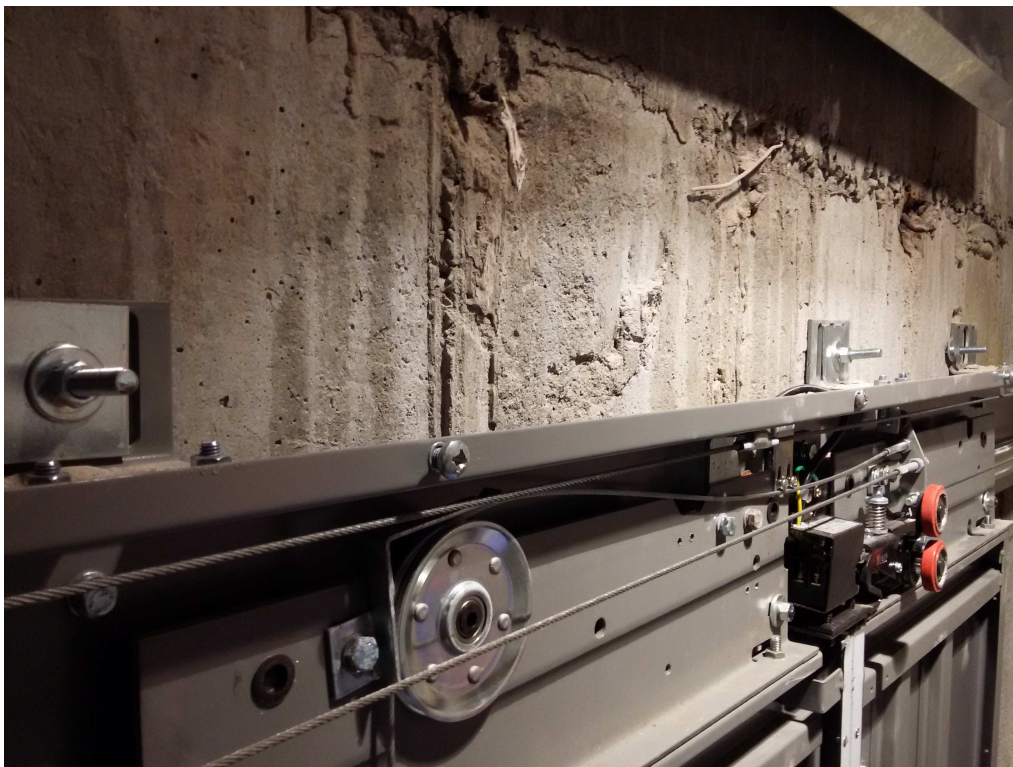
Рисунок 66 – Смонтированный подвесной механизм (головки) шахтных дверей
