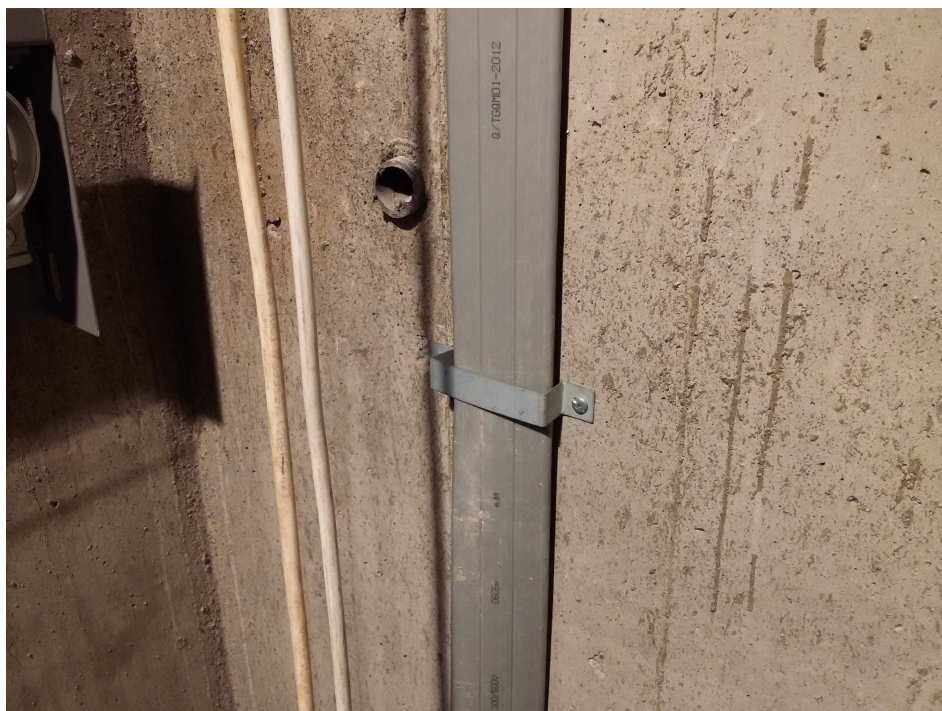
Рисунок 70 – Закрепление подвесного кабеля в шахте
