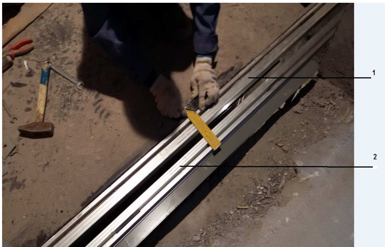
Рисунок 61 – Смонтированные пороги кабины и этажных дверей
