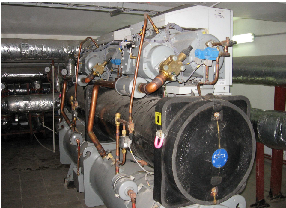
Рисунок 5 – Общий вид чиллера, смонтированного на объекте
