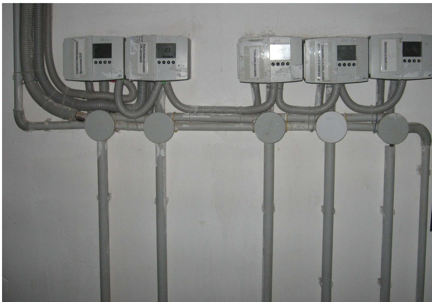
Рисунок 7 - Общий вид смонтированных элементов системы автоматики
