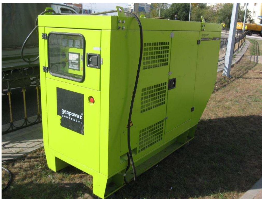
Рисунок 11 - Общий вид дизельного генератора мощностью 60 кВт
