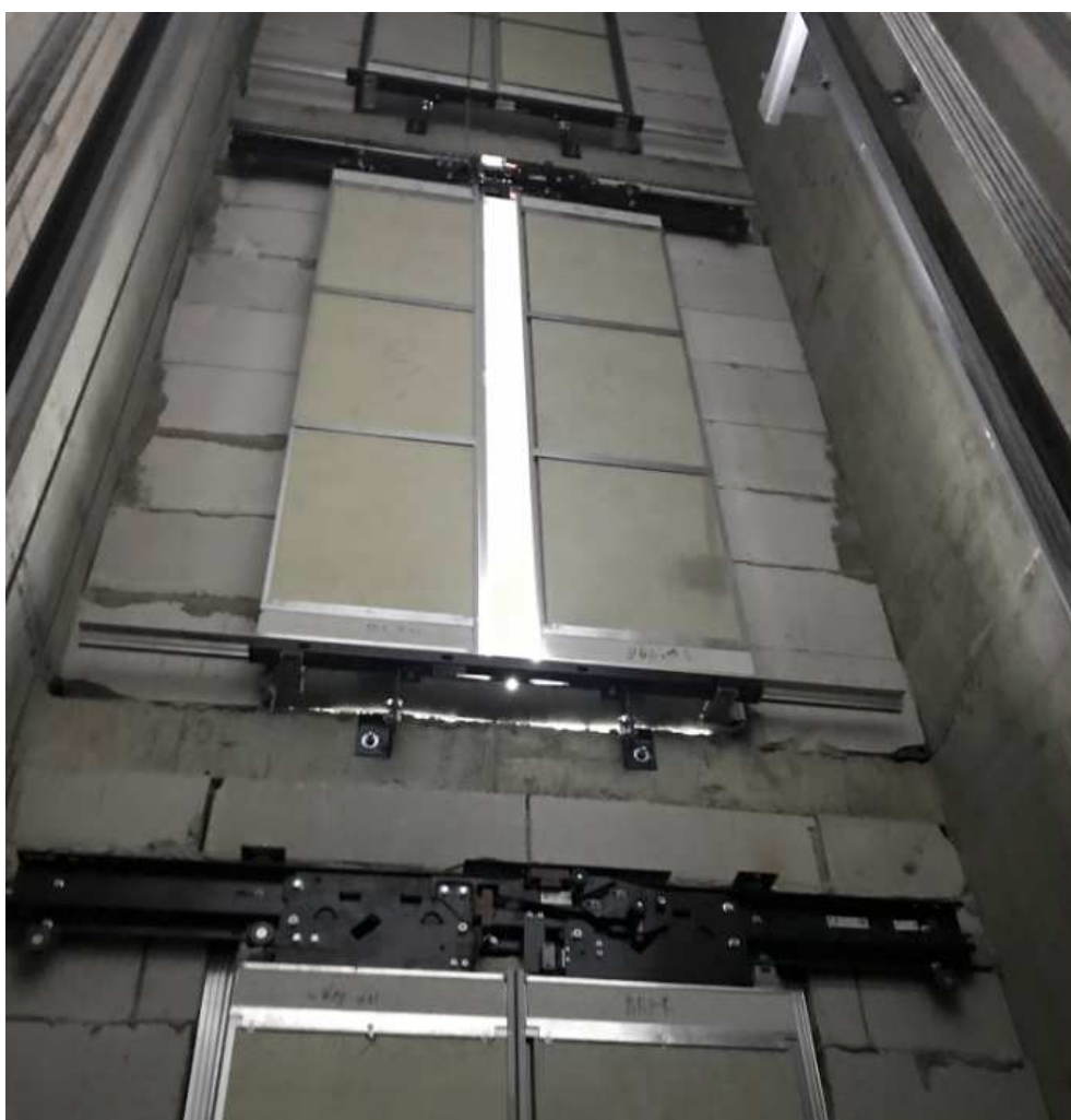
Рисунок 49 – Общий вид установленных порога посадочных площадок и подвесных механизмов шахтных дверей
