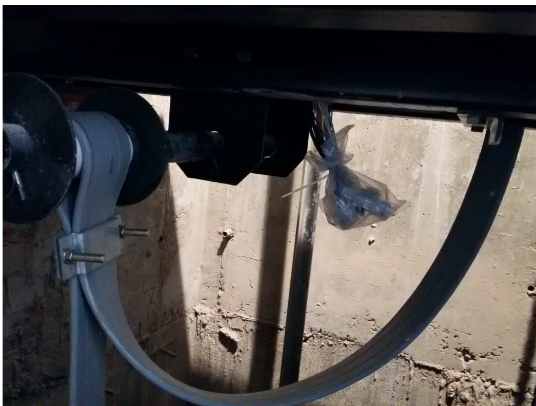
Рисунок 54 – Закрепление подвешного кабеля на каркас кабины снизу
