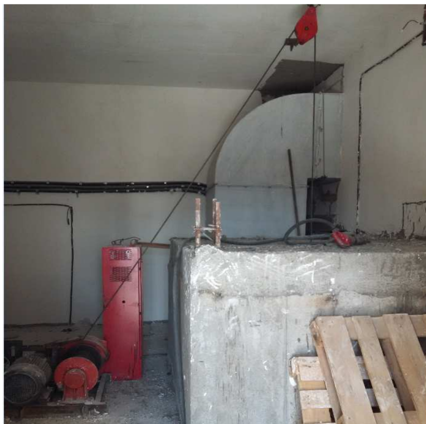
Рисунок 9 – Монтажная лебедка при наличии машинного помещения
