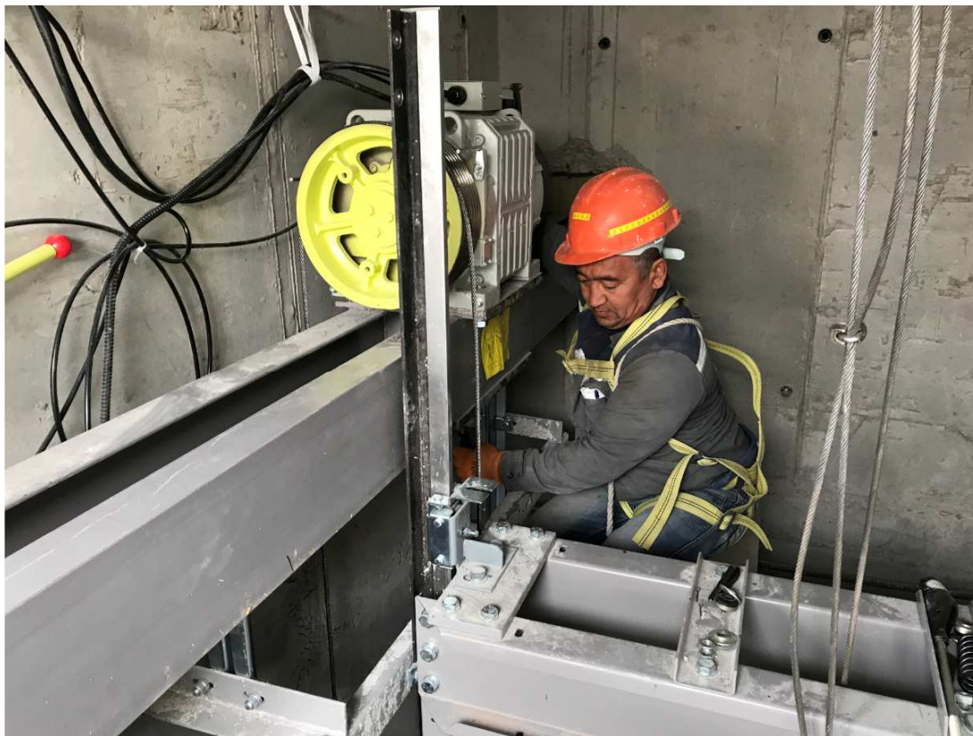
Рисунок 33 – Общий вид шахты лифта без машинного отделения перед запасовкой канатов
