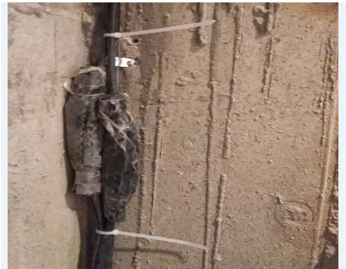
Рисунок 52 – Крепление электропроводки в шахте
