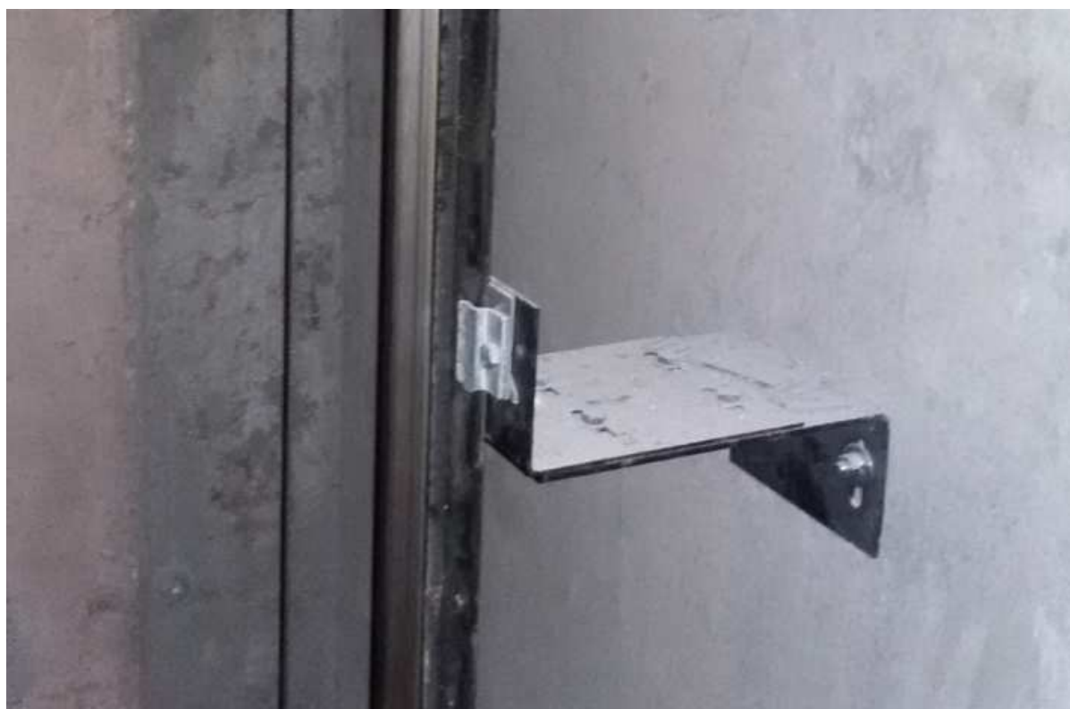
Рисунок 16 – Закрепленные к кронштейнам направляющие кабины
