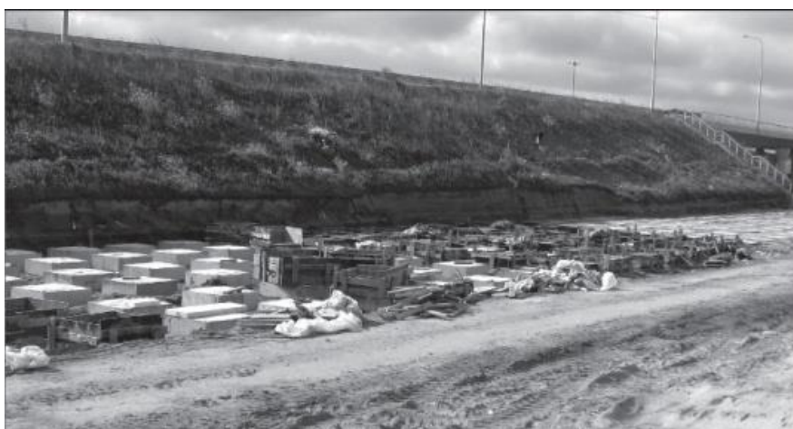
Рисунок 41 - Устройство оголовков монолитного типа при сооружении свайного фундамента под примыкание к существующей дороге
