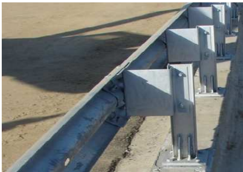
Рисунок 4 – Рабочий участок одностороннего дорожного ограждения
