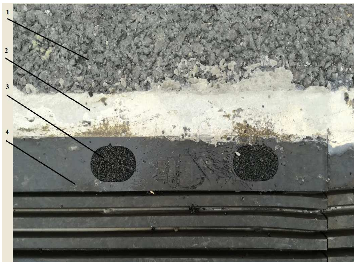
а) 1 – асфальтобетонное покрытие, 2 – забетонированная бровка ДШ цементным раствором с армированными стальными жесткими волокнами и щебнем фракции 10-20мм, 3 – анкерный колодец модуля-гармошки, 4 – резинометаллический модуль – гармошка
