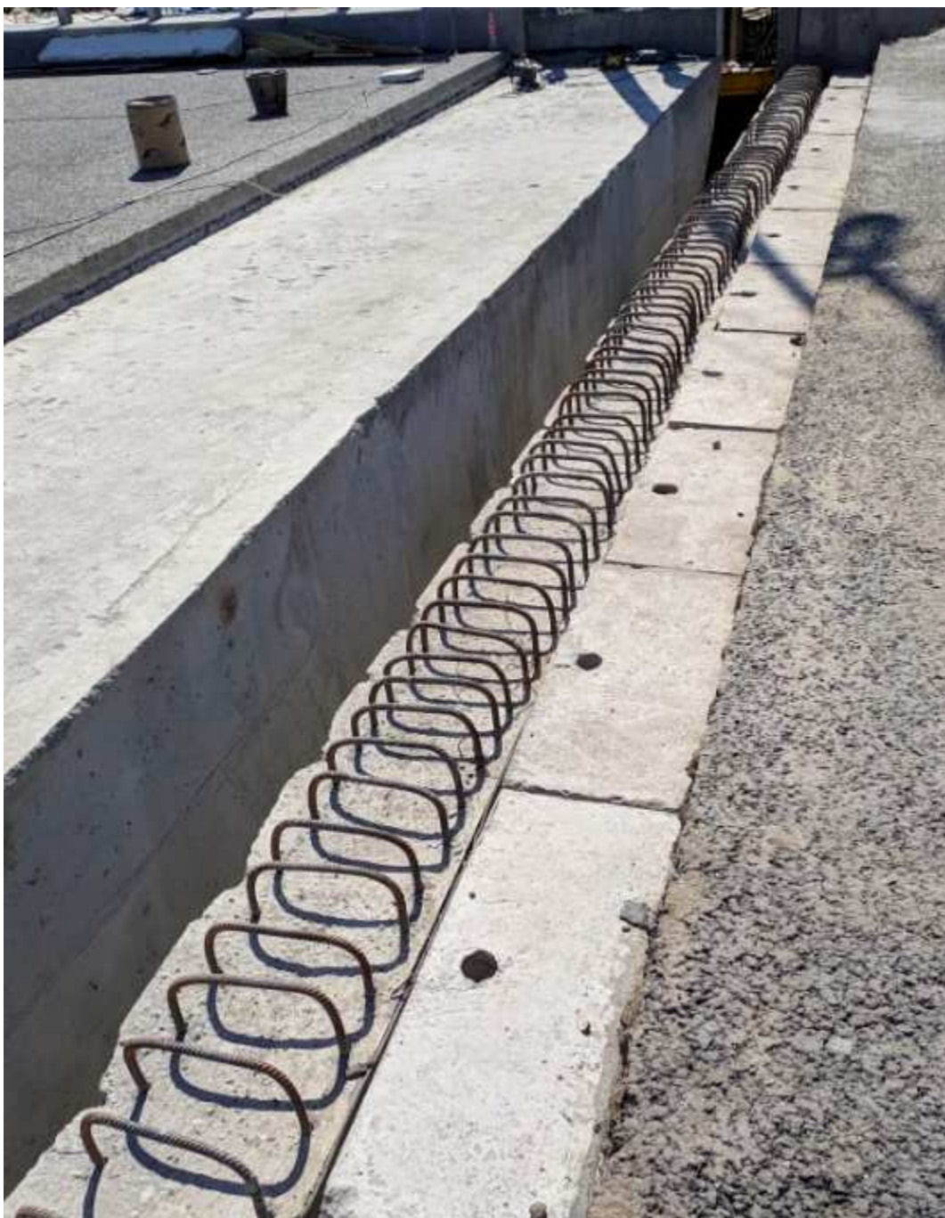
Рисунок 14 - Штраба деформационного шва пролетного строения моста
