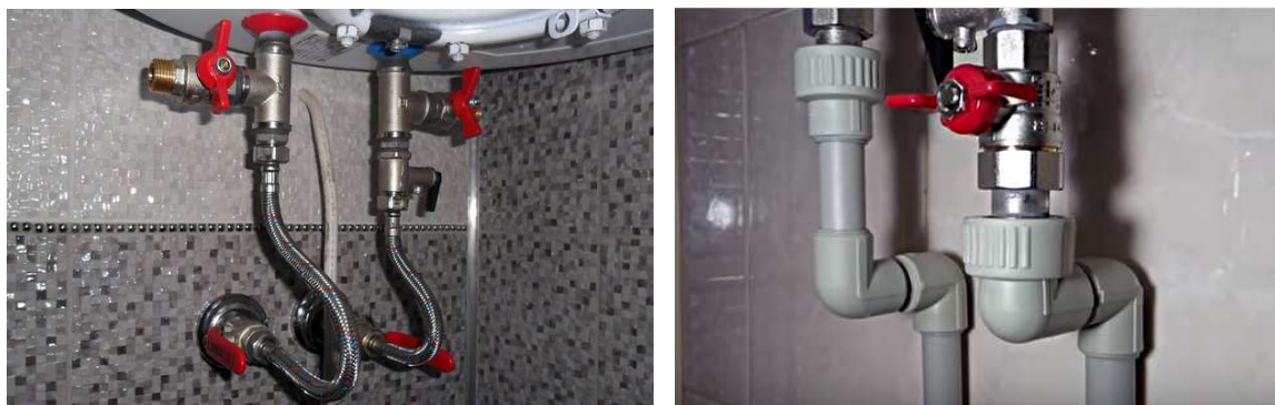
Рисунок 10 - Соединения водонагревателя с магистралью на гибких шлангах и ПВХ трубах
