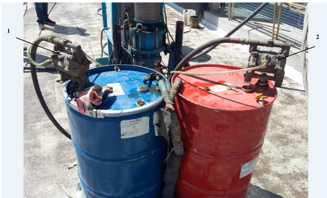
Рисунок 19 – Общий вид установки с питающими насосами
